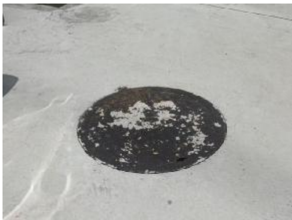
水保措施（检查井）
